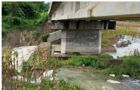
Gambar 2. Kerusakan Pada Bagian Spillway Sisi Kanan (beritajatim.com, 2019)
