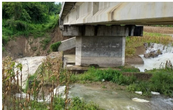
Gambar 2. Kerusakan Pada Bagian Spillway Sisi Kanan (beritajatim.com, 2019)
